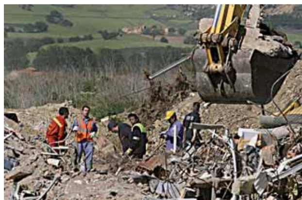
Búsqueda entre los escombros del edificio, ayer. EFE/BRÁGIMO
