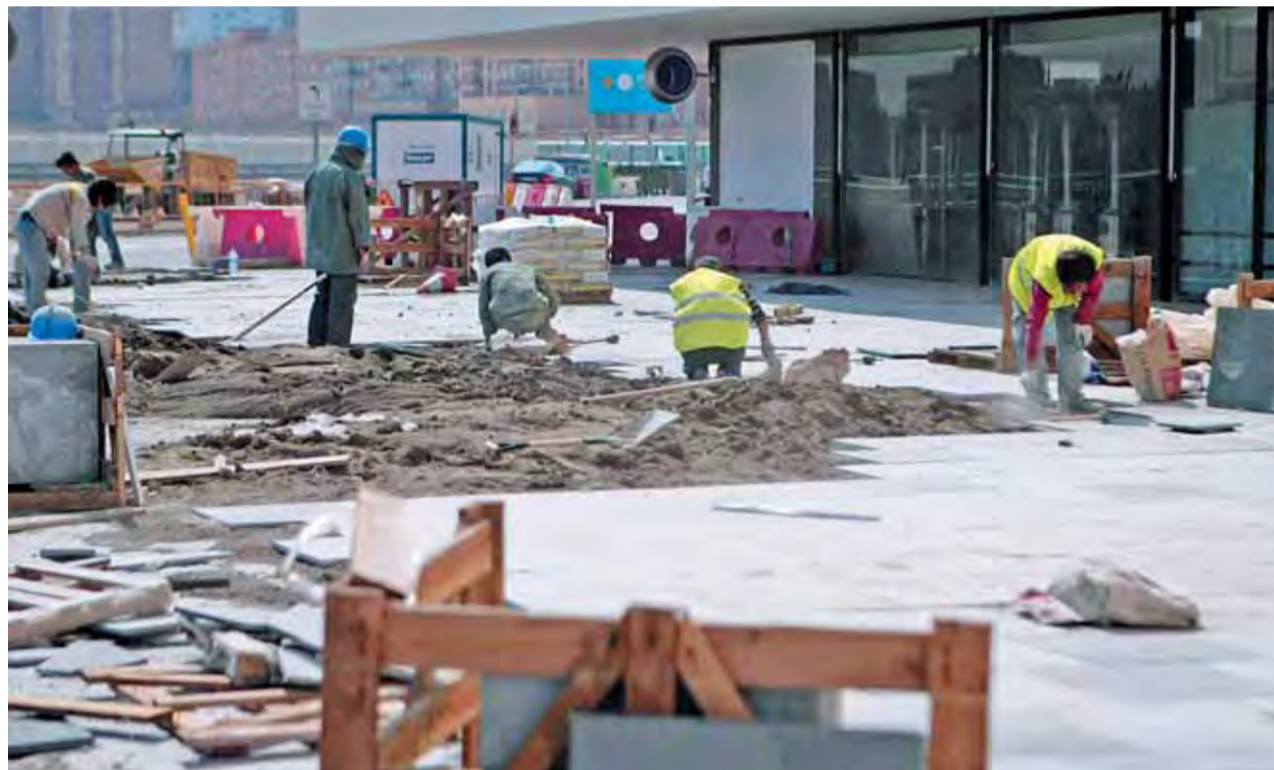
Varios operarios embaldosan las aceras que conducen a la entrada de la Estación Central de Autobuses, ayer. MARINA OVEJERO
