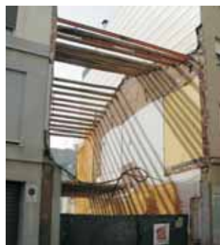
Centenars d'edificis d'arquitectura tradicional han estat enderrocats en poc temps
