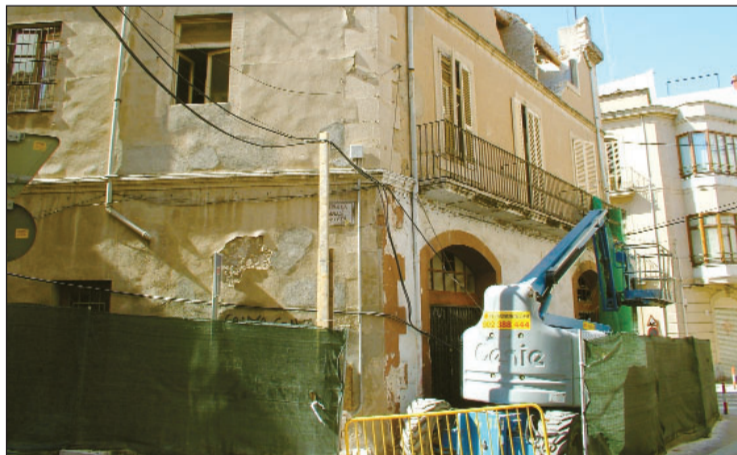
L'immoble del carrer Ferrers cantonada Muralla dels Vallets. Foto: 7dies.net
