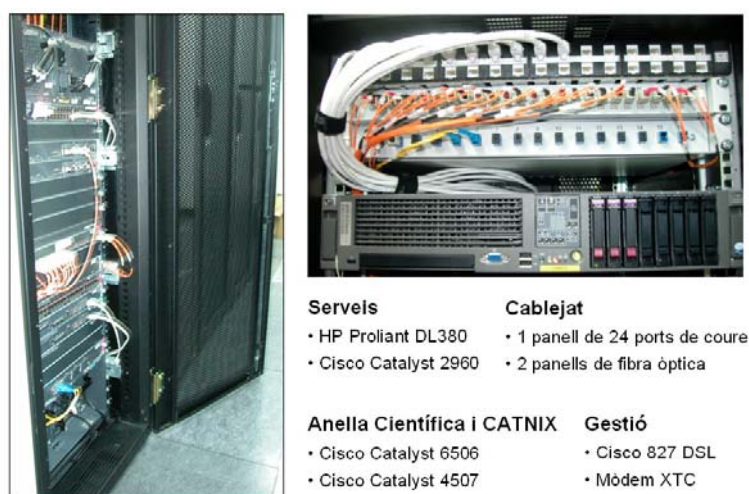
Figura 17. Les instal·lacions tècniques a Telvent
