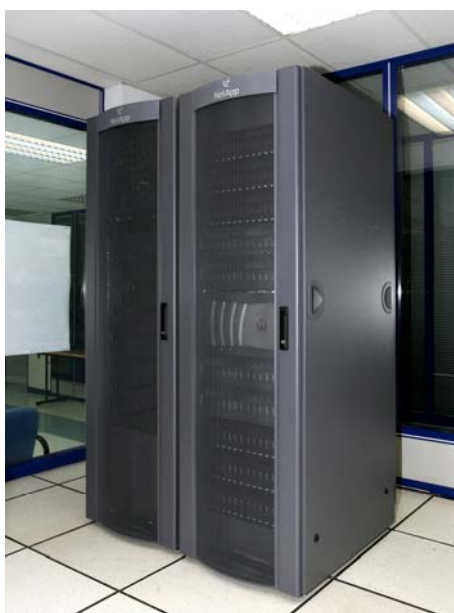
Figura 14. La cabina NetApp FAS3170
