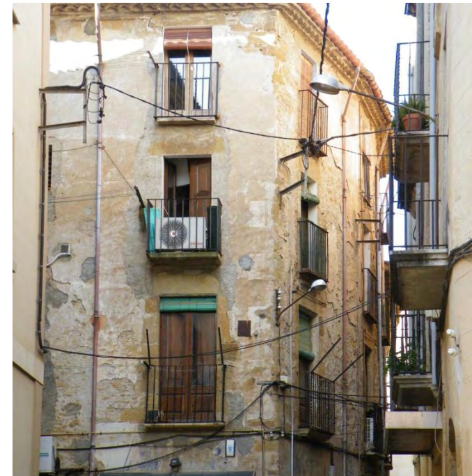
Imatge 21. Estat de la xarxa elèctrica
