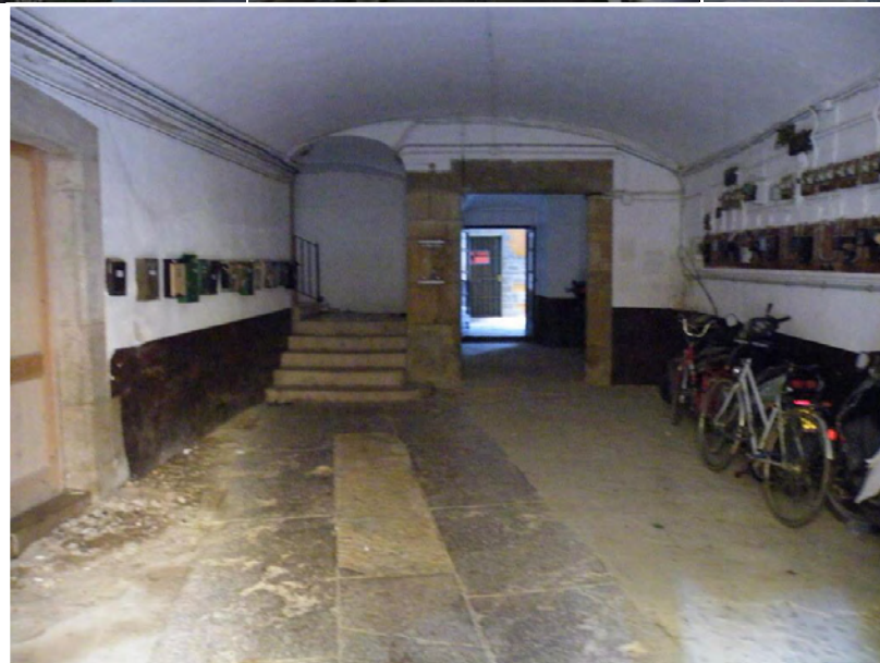
Imatge 5. Edificis en mal estat
