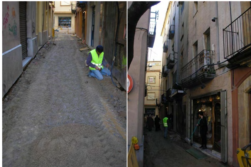
Imatge 15. Carrers en obres per repavimentació i reposició dels serveis (Pla Especial del Nucli Antic)
