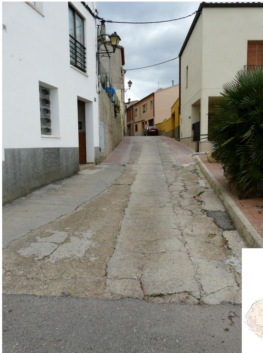
Il·lustració B11 La majoria de carrers del Nucli Històric estan pavimentats amb formigó, que s'ha anat degradant amb el pas dels anys
