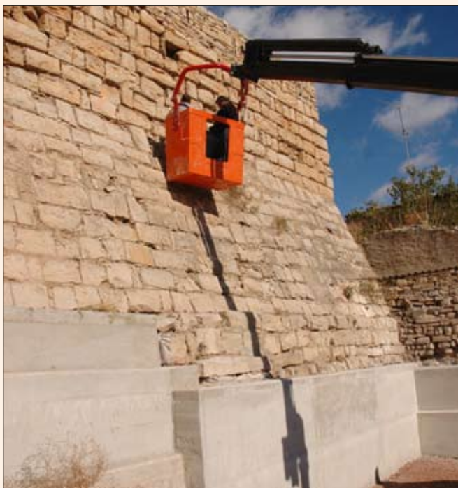
El mur sud del castell, del segle XV, patia risc d'esfondrament
