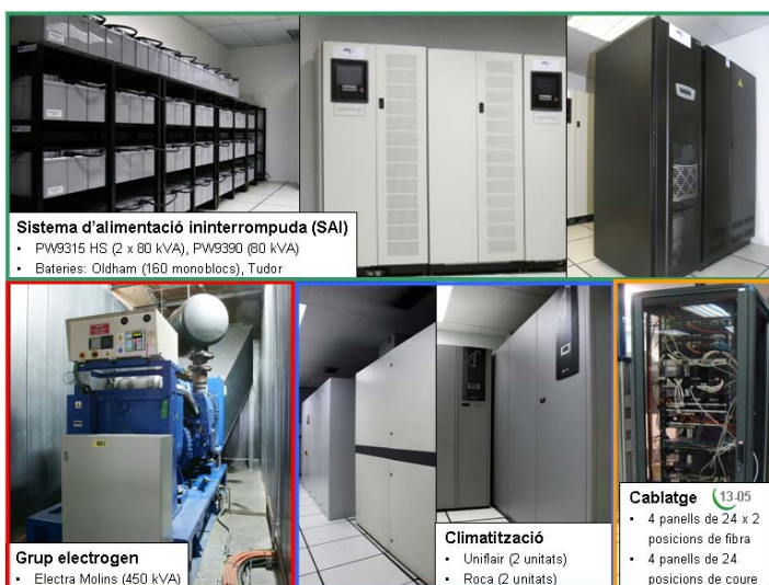
Figura 22. Les instal·lacions tècniques a l'Edifici Annexus
