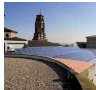
Instal·lació solar fotovoltaica a la coberta d'un edifici
