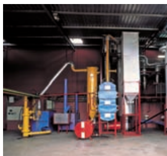
Instal·lació d'aprofitament de biomassa agrícola
