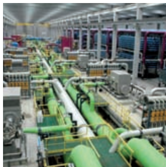
Edifici d'osmosi de la planta dessalinitzadora del Llobregat (2009)
