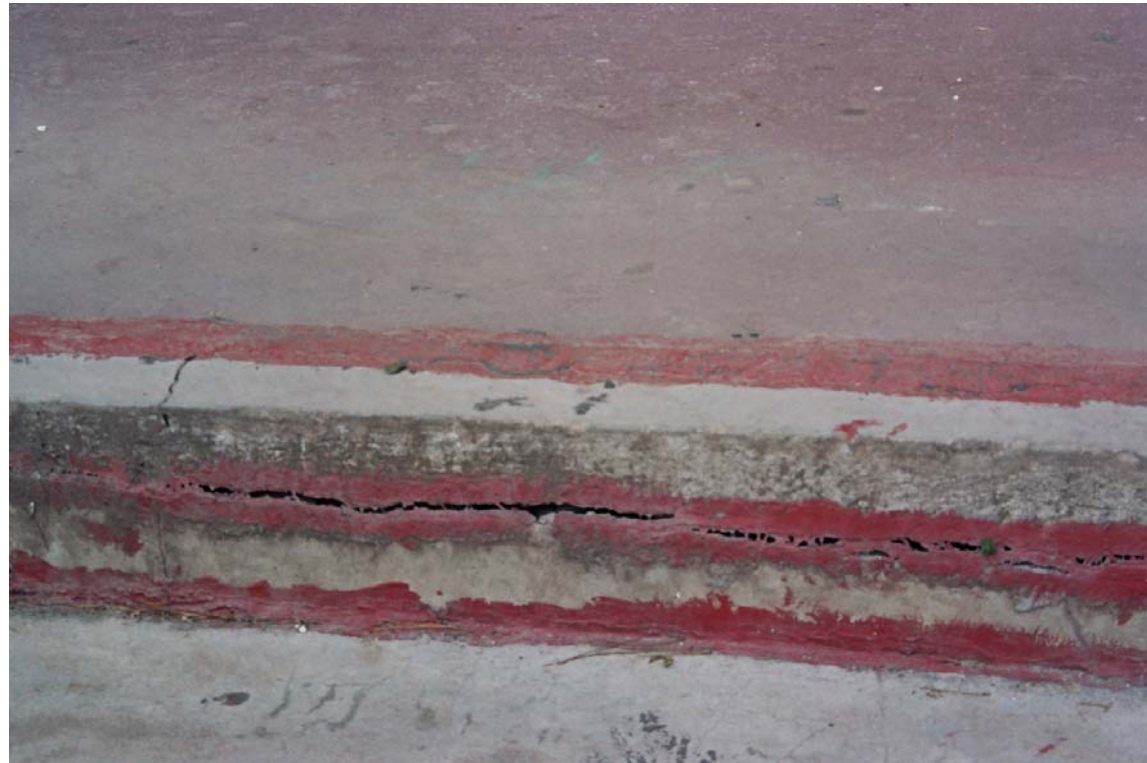
Junt obert en el paviment de la plaça de Sant Miquel del Cros per on es filtra l'aigua cap als aparcaments
