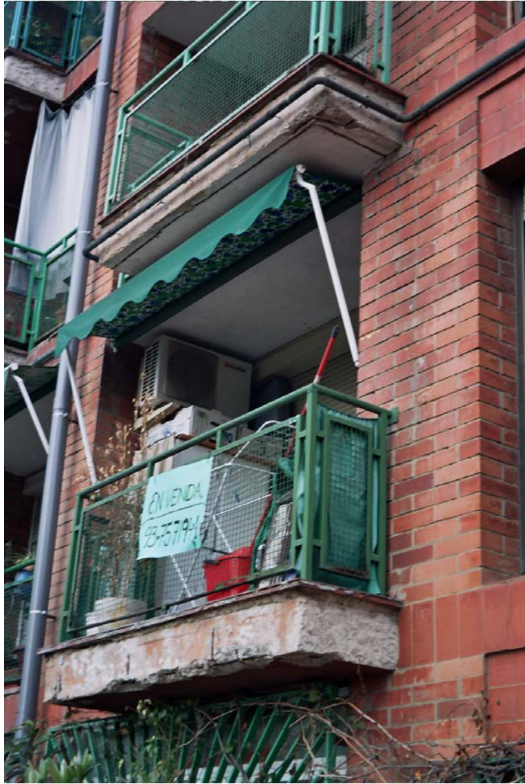
Balcó amb despreniment de rajola ceràmica.
