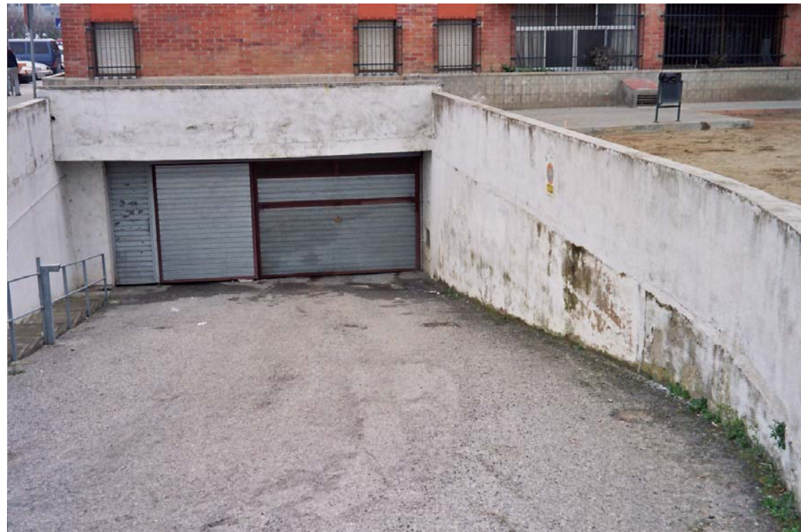
Rampa d'entrada a un aparcament. Vegeu les taques produïdes per la humitat.
