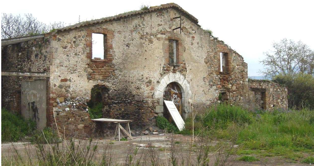
Foto 58: Runes de l'antiga masia de Can Català, al nord del circuit de Catalunya. Els còdols del riu van ser emprats en la seva construcció.
