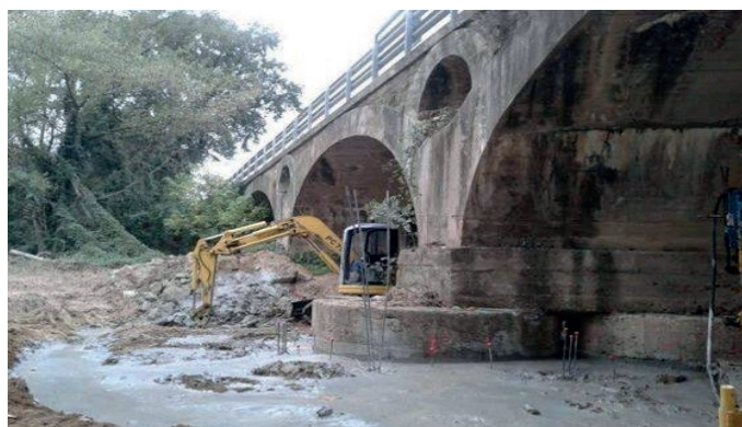
La carretera d'Hostalric va estar quasi tres mesos tallada pel desfalçament d'un pont per una rierada, sense informació a la població
