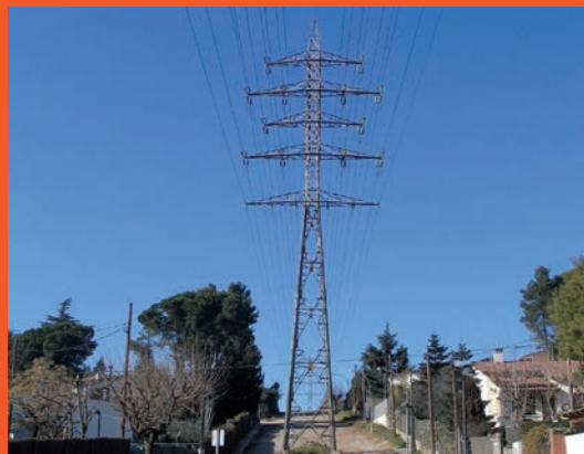
Torre elèctrica a l'avinguda del Baixador
